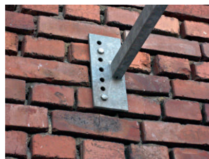
Die Konstruktion wurde fehlerhaft mit Schlüssel-schrauben und Nypondübel im Klinker verankert
