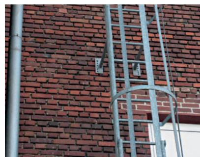
Die Treppe ist nach der Begutachtung durch Walter Heinrichs sofort gesperrt worden ...
